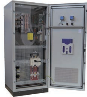
Alimentatore Ingresso Trifase Uscita 24VDC 500A in armadio con protezioni e strumenti
